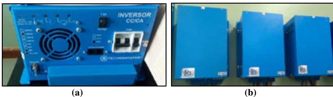
Figura 25 – Inversor Trifásico – (a) Detalhe da Potência e Fabricante – (b) Instalado
