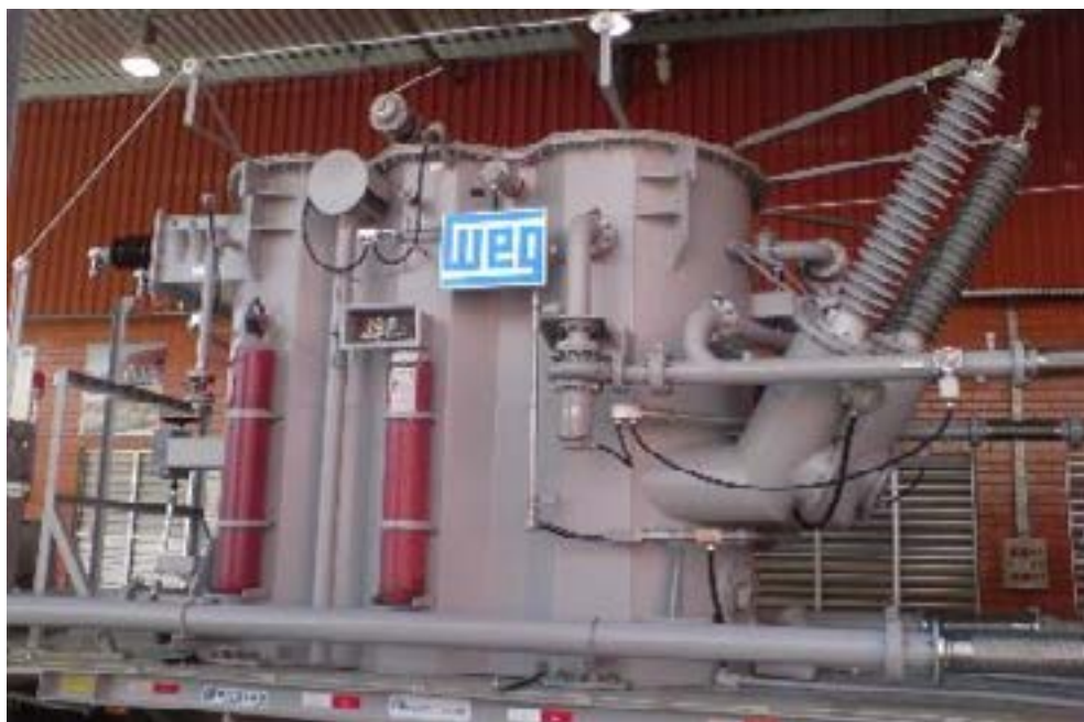
Figura 8: Transformador montado sob subestação móvel.
