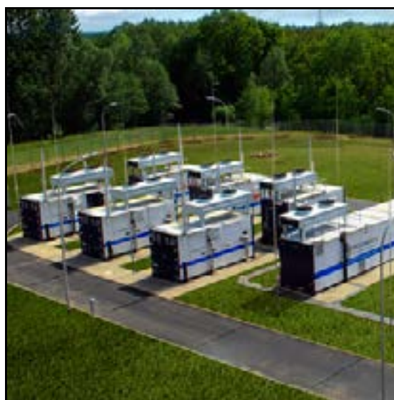
Figura 10 – Sistema de eletrólise em Falkenhagen, na Alemanha [10]
